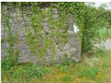
67. ábra - Kerítésfal erősen repedezett állapotban, a G19-es helyiséggel szemben
