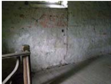
58. ábra - 10mm széles repedés padlótól az ablakig, helyiség F16
