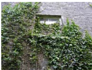
83. ábra - részlegesen befalazott ablak a G10, F10 és S6 helyiségeknél a nyugati homlokzaton
