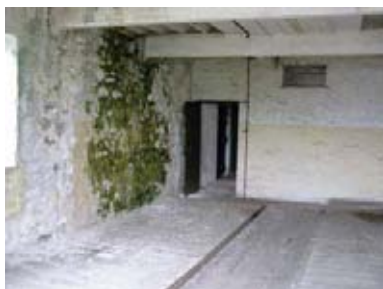
85. ábra - Vízbeszivárgás okozta károk az F11 helyiségben
