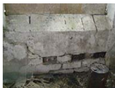
55. ábra - Tönkrement parapet az S11-es helyiségben, északi homlokzat
