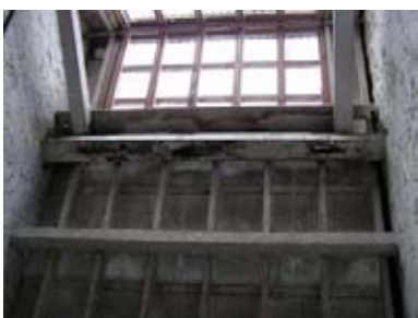
100. ábra - A fa fedélszerkezet károsodása a bejutott nedvesség miatt az S8 helyiség felett
