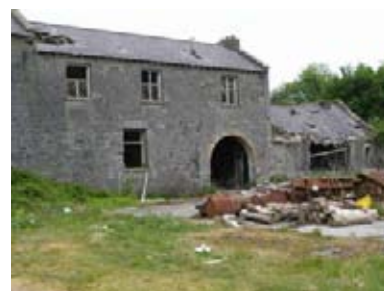
108. ábra - A G46-47-48 jelű helyiségeknél a déli homlokzat, a G48 felett beomlott fedélszerkezet
