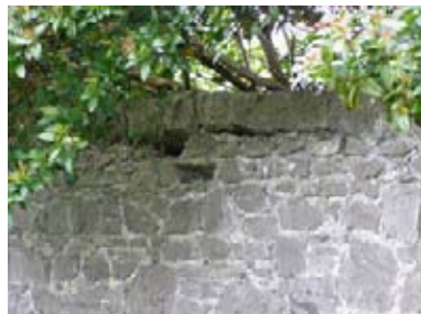
70. ábra - Sérült kerítésfal, Y08-as kert, déli homlokzat
