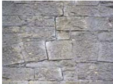
69. ábra - Végig futott repedés az északi homlokzaton
