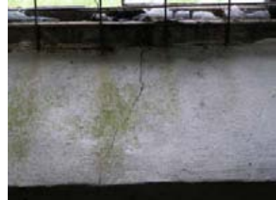
72. ábra - Megrepedt parapet, délkeleti sarok, G19
