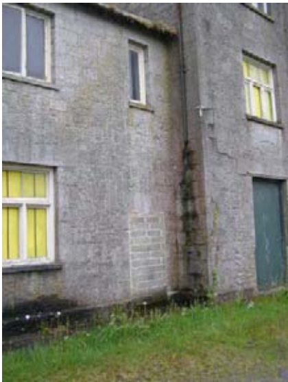
61. ábra - Befalazott ajtó és szivárgó csatorna a G15 és G18 helyiségek között az északi homlokzaton
