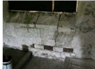
73. ábra - repedt parapet, északi homlokzaton, F16-os helyiség
