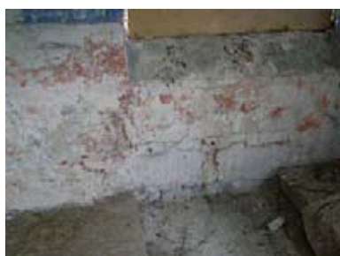
47. ábra - északi homlokzaton, S6-os helyiségben repedt parapet
