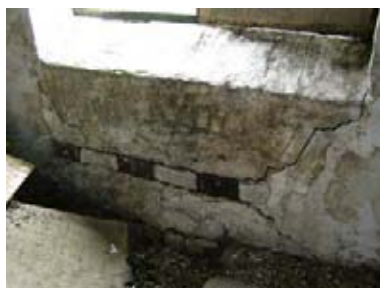
51. ábra - A déli oromfalnál lévő S6-os helyiségben megrepedett parapet
