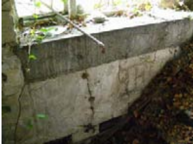
64. ábra - repedés az F16-os helyiségben a déli homlokzaton
