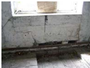
59. ábra a - Megrepedt parapet, déli homlokzat, F15
