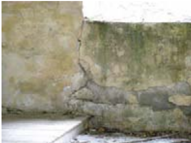
65. ábra - Megrepedt parapet, déli homlokzat, F11
