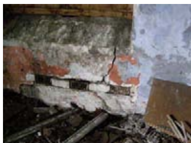
48. ábra - A déli homlokzaton lévő S6-os helyiségben szétrepedt parapet
