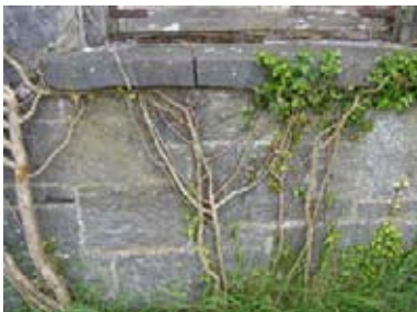
66. ábra - G19-es helyiség ablaka alatti repedések
