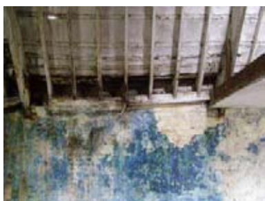
106. ábra - Elrohadt fedélszerkezet, deformálódott fedés, S6 helyiség
