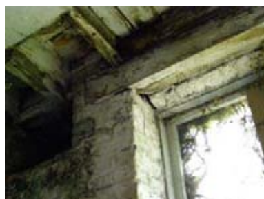
90. ábra - Rohadó fa áthidaló és repedés az F16-os helyiségben a déli homlokzaton
