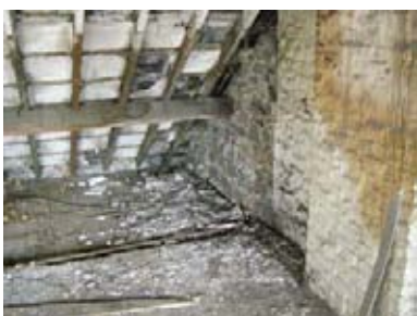
98. ábra - Hulló vakolat és károsodott oromfal az S2 helyiségben
