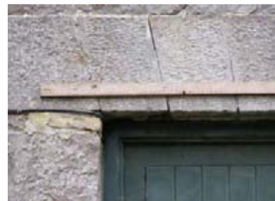
75. ábra - Repedés ajtó fölött G18 helyiség
