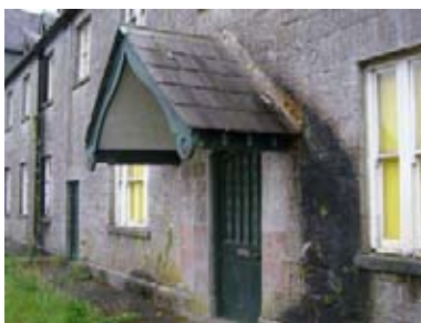
103. ábra - Eldeformálódott előtető a főbejárat felett
