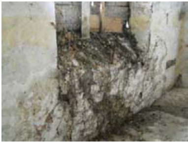
56. ábra - Vegetáció az épületben, károsodott falak, helyiség G9
