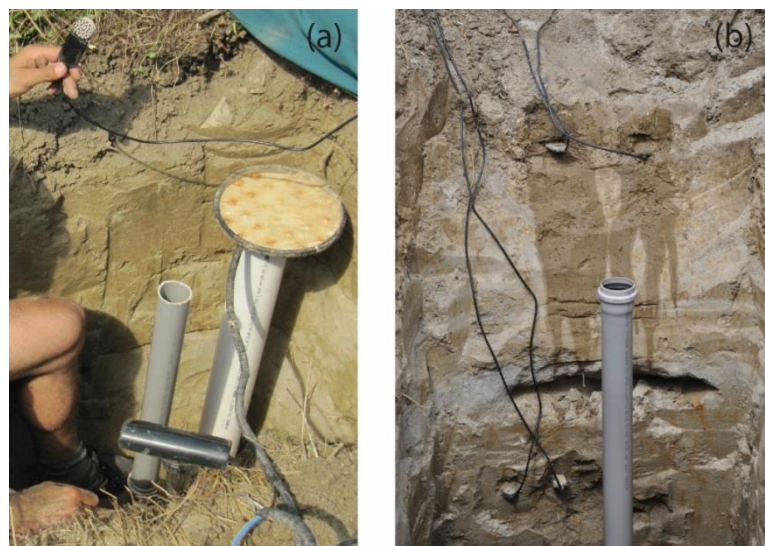
14. ábra Decagon MPS-2 szenzorok telepítése Cún-1 és Cún-2 talajfizikai monitoringállomásokon (saját felvétel)
