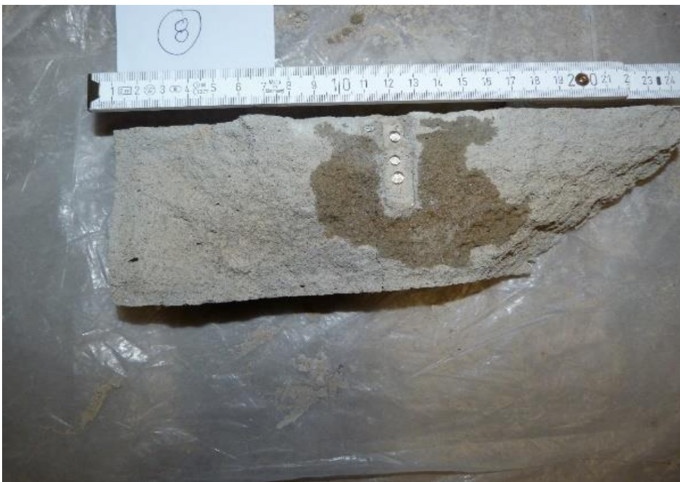
Bild 42: Ausbreitung IM bei D(g) 60%, Hersteller 2. Auch hier außer in unmittelbarer Nähe des Bohrloches kaum eine Ausbreitung feststellbar [11]
