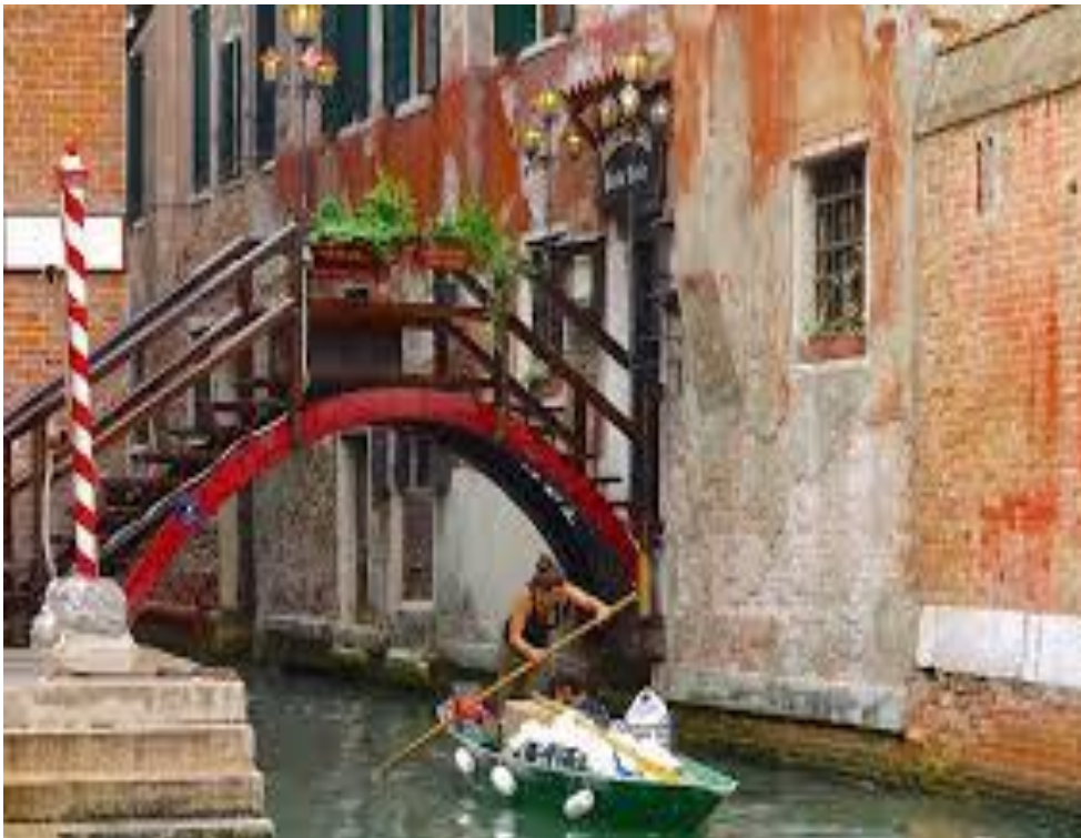
Bild 2: Gebäudeschaden durch aufsteigende Feuchte (Quelle: www.passengeronearth.com )
