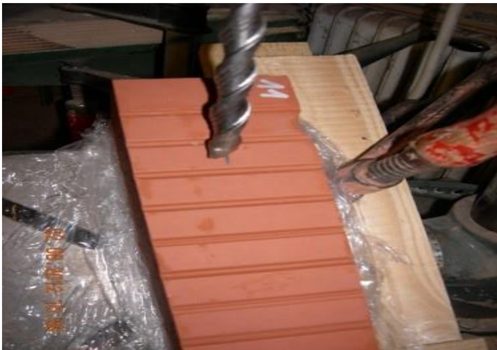
Bild 28. : Herstellen des Bohrloches nach Angaben des Herstellers. Zur Optimierung der Bohrung ist der Prüfkörper mittels Schraubzwingen fixiert. Anschließend ist zur Vermeidung des Verbleibens von Bohrmehl das Bohrloch mit ölfreier Druckluft auszublasen.
