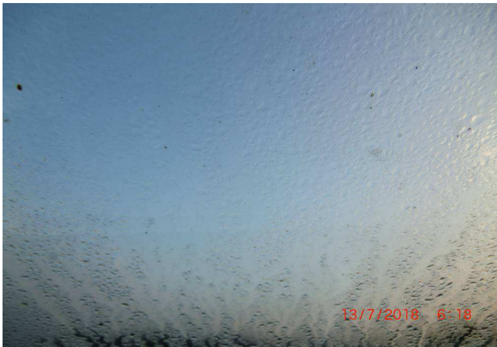
Abb. 42: Tauwasserausfall auf einer Glasscheibe im Sommer 2018.
