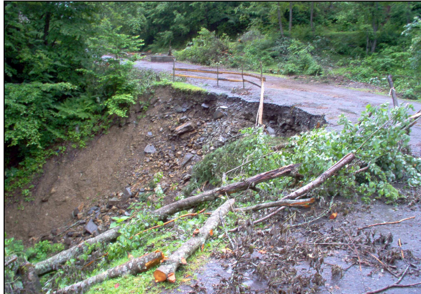
31. ábra: A talaj kimosódása által megsérült úttest a Talabor völgyében, a Talabori víztározó mellett (Huszi járás).
