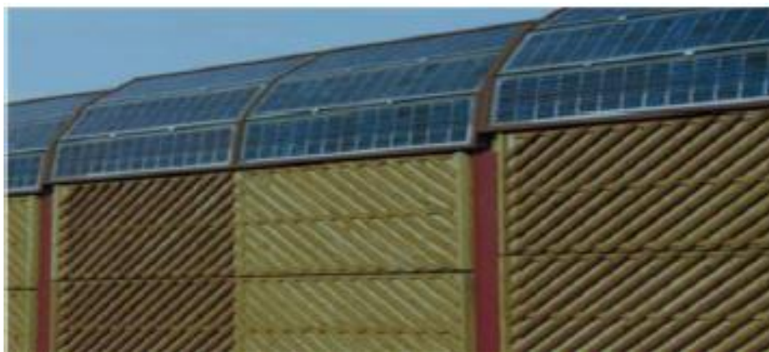
295. ábra. Villamos elemekkel felszerelt zajárnyékoló fal
